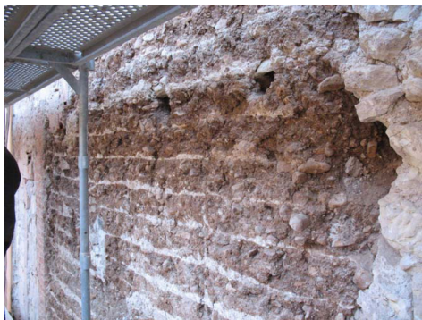
Figura 4. Detall de l'estat de la tàpia de la 2a planta on es veuen en molta claretat els encofrats de 20 cm de gruix amb la terra i les separacions de calç.
