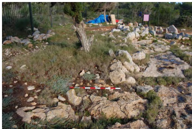
Figura 2. Fotografia inicial de la campanya 2016, costat sud-oest. S'observa la savina al bell mig del mur, a conseqüència d'això les lloses del parament s'han desplaçat i han mogut la línia.
